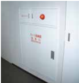
屋内消火栓（参考写真）
