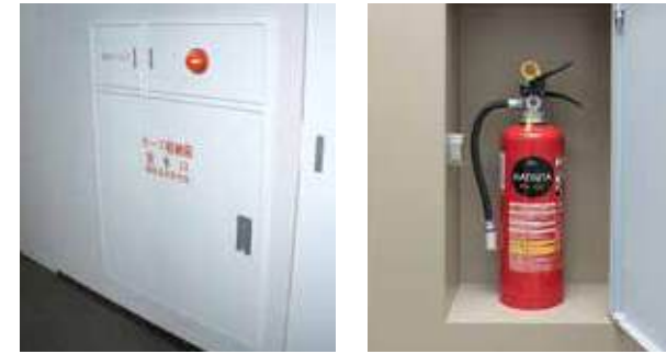
屋内消火栓(参考写真)
